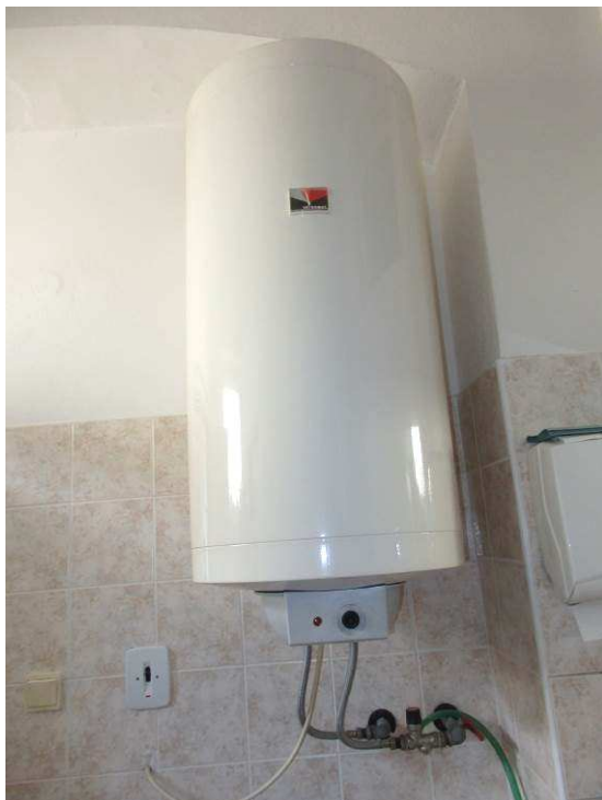
Príprava teplej vody
